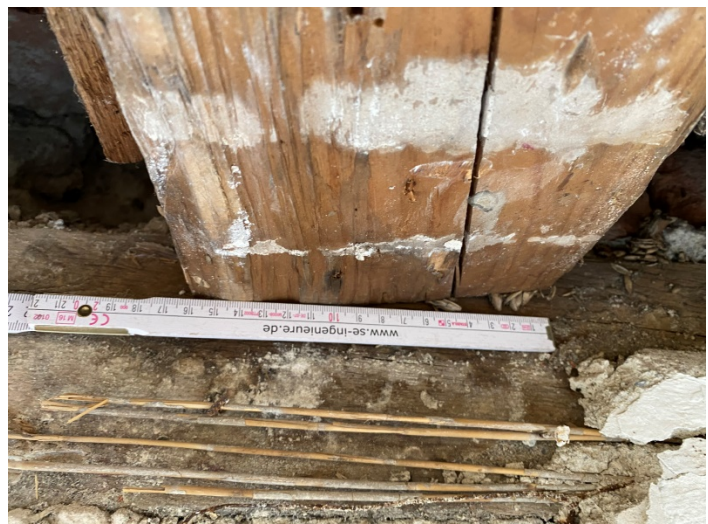
Abb. 4: Gemessene Balkenquerschnitte bei Bauteilöffnung 1 im Gastraum EG
