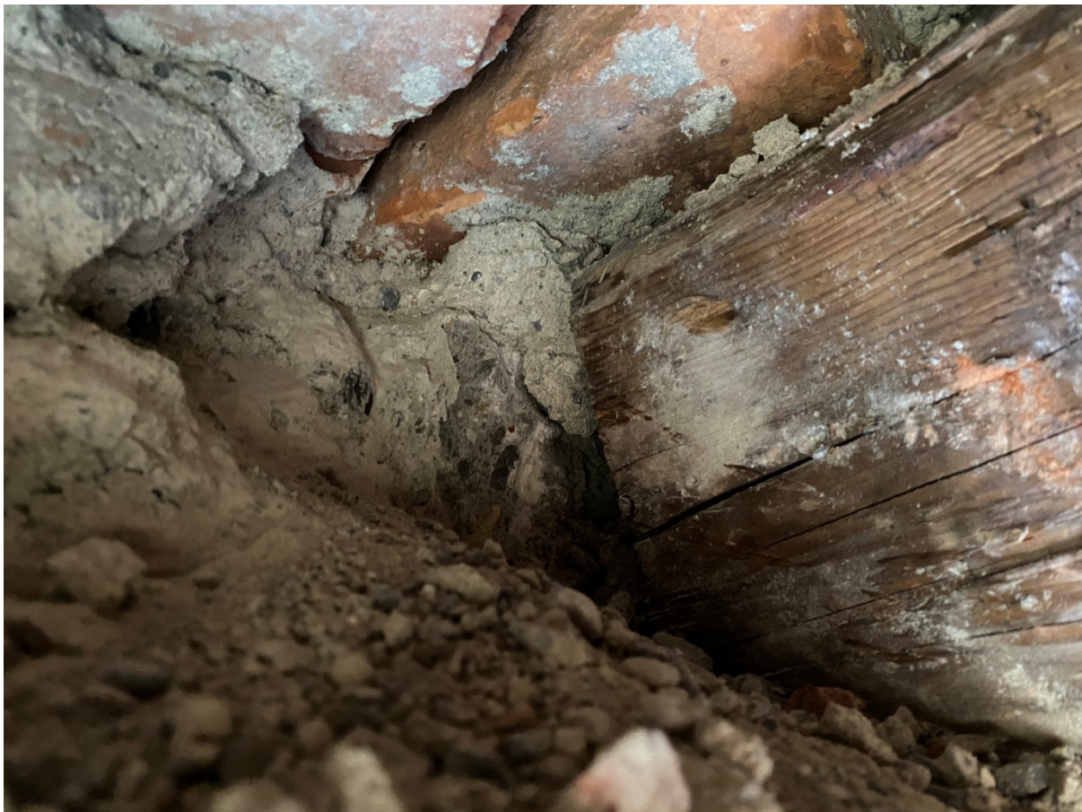
Abb. 5: Auflagerpunkt Holzbalken bei Bauteilöffnung Nr. 3 mit Dunkelverfärbung infolge erhöhter Holzfeuchtigkeit
