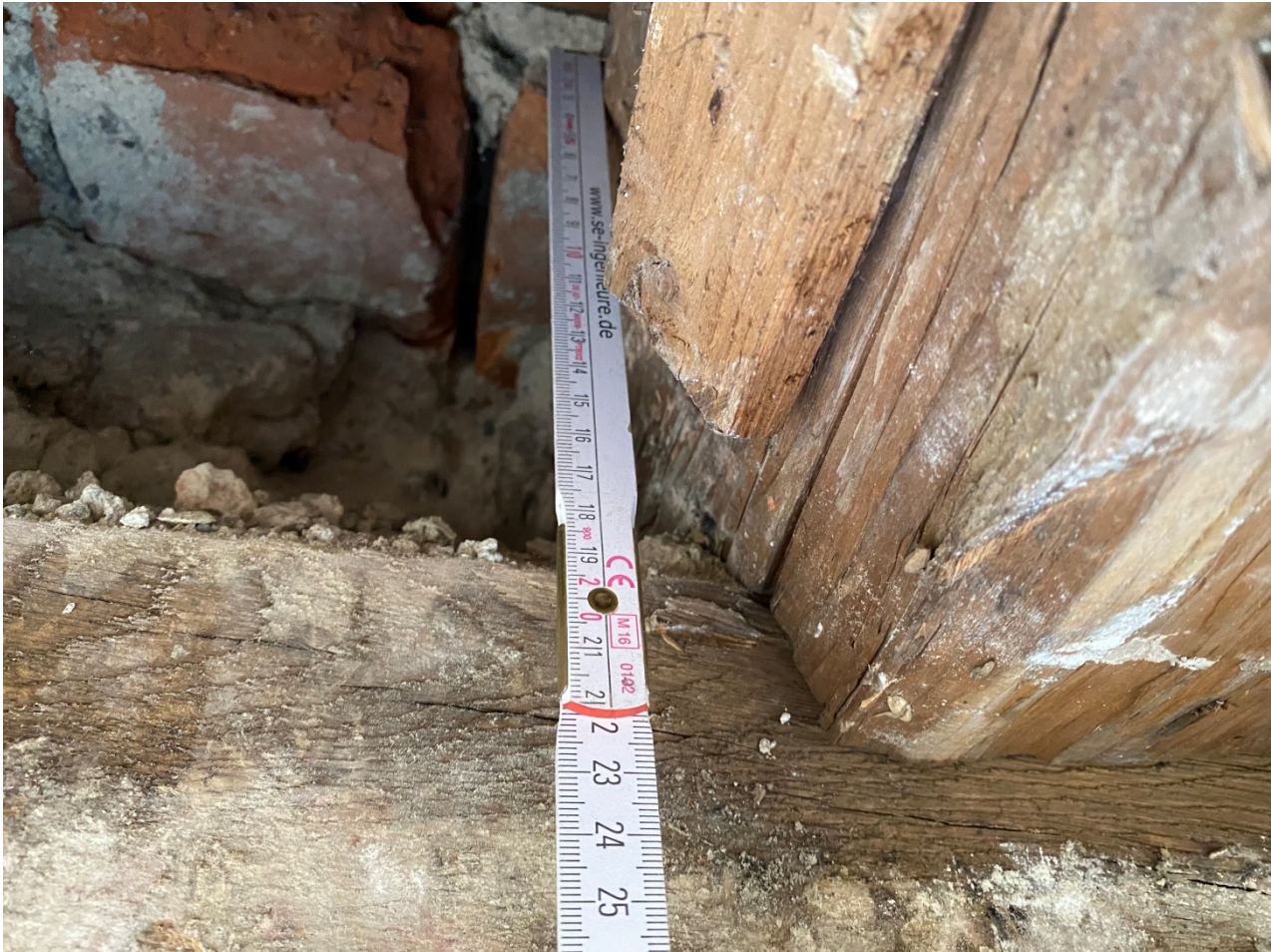
Abb. 6: Um 3 cm hoch liegendes Auflager (unterseitige Ausklinkung) am Auflagerpunkt der Holzbalken
